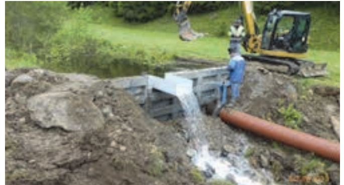
Bild 1: Dotationswehr; dieses vorgefertigte Wehr wurde vom Konsensgeber entwickelt und ist relativ schnell und ohne gravierende Eingriffe in das Fließgewässer auf- und abzubauen.
